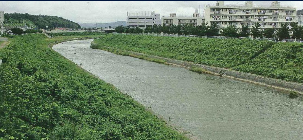
写真1 I川：改修済み区間。川幅は一定、川底は平できる河原一つない。写真2は、階段はないが
